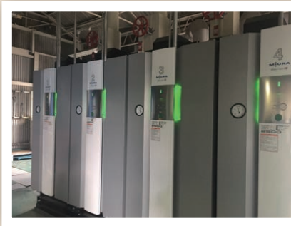
都市ガスを利用したボイラー
