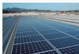
九州工場太陽光パネル
