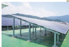
韓国子会社の太陽光発電設備
