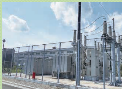
東大垣工場の特別高圧受電設備
