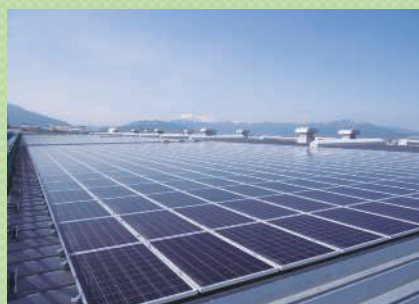
東大垣工場の太陽光パネル
