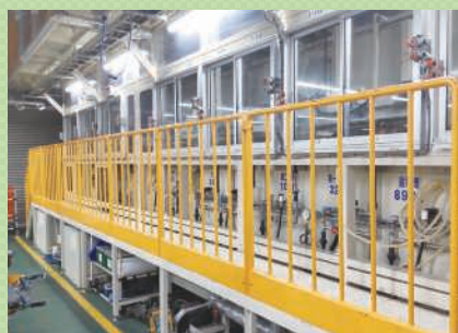
西大垣工場のカチオン電着塗装設備
