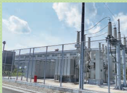
東大垣工場の特別高圧受電設備
