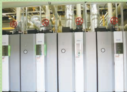
東大垣工場に導入した小型貫流型ボイラー
