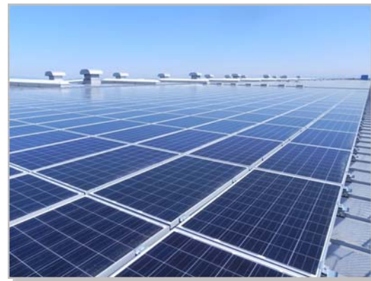
屋根に設置された2000枚の太陽光パネル
