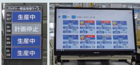
集中稼働モニター
